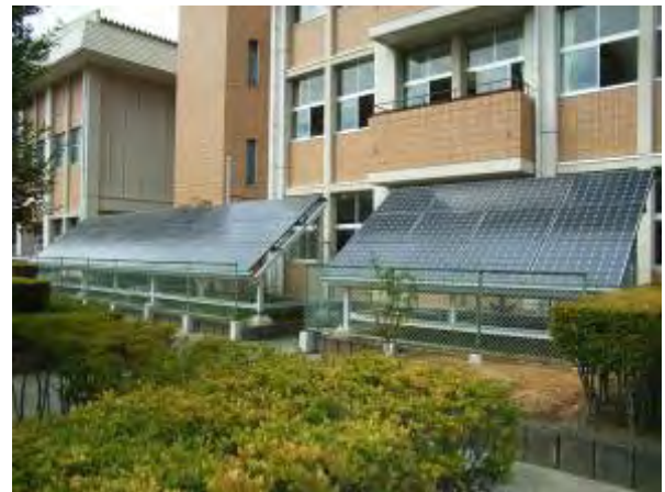
(南越中学校 太陽光発電施設)
