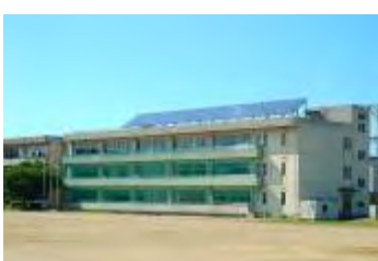
今町中学校（約20kw、屋上に設置）
