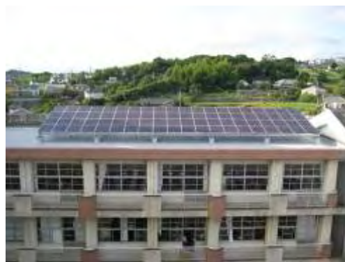
(大村中学校 太陽電池パネル)
