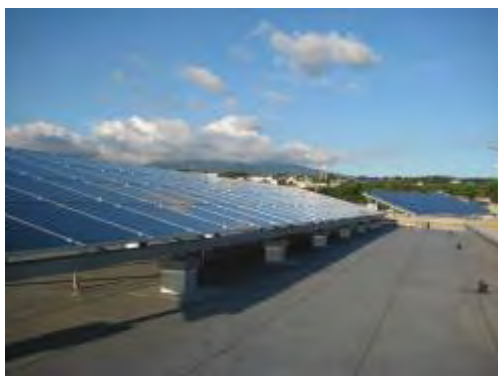
(旭が丘小学校 太陽電池パネル)
