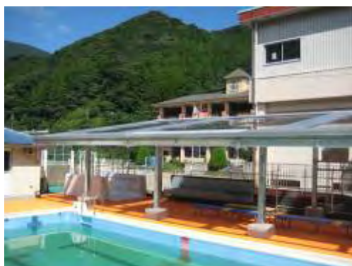
(黒木小学校 プールサイド庇兼用太陽電池パネル)
