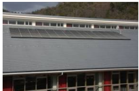
(体育館棟に設置した太陽光発電パネル)
