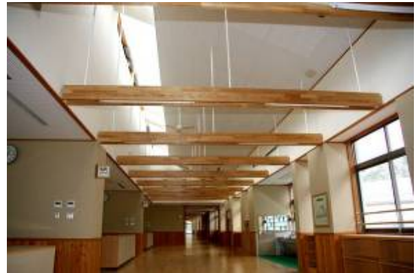
(写真左上部：自然換気システム)
