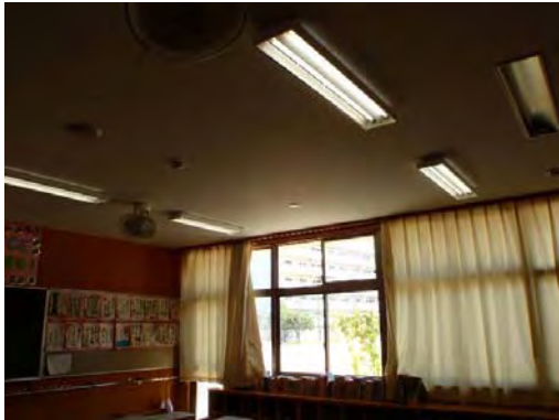
(昼光利用照明制御の照明器具)
