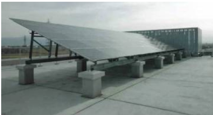
屋上に設置した太陽光発電設備
