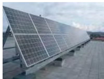
【太陽光パネル】
