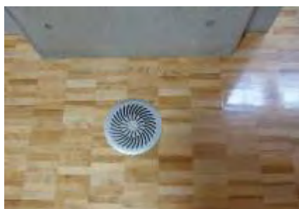
【地中熱吹き出し口】
