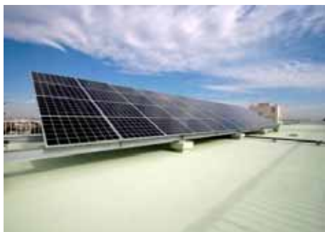
【普通教室棟屋上の太陽光発電】
