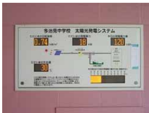
(写真：多治見中学校に設置した太陽光発電システム)
