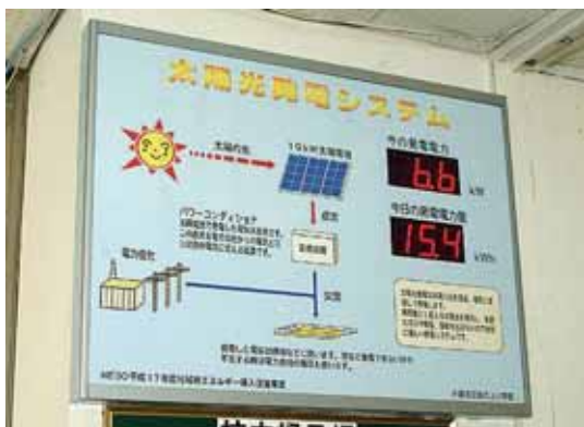
【各学校に設置した太陽光発電の表示パネル】
