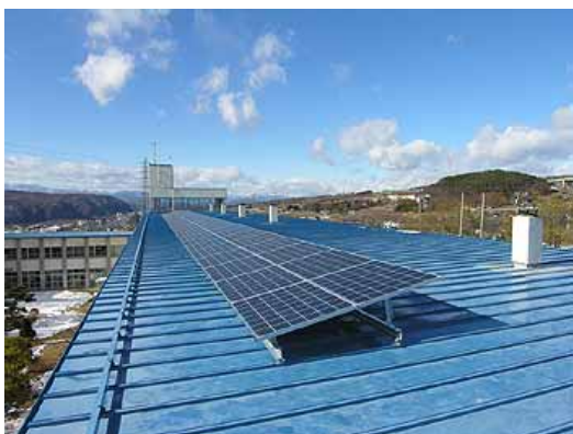
【水明小学校に設置した太陽光発電パネル】
