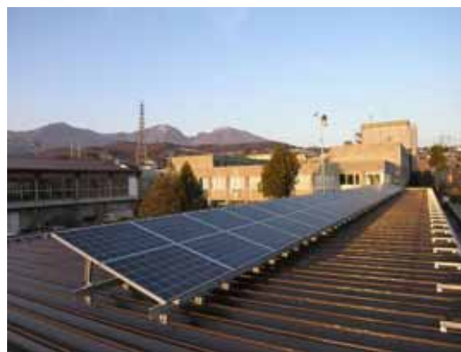
【坂の上小学校に設置した太陽光発電パネル】
