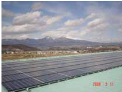
浅科小学校の太陽光発電設備
