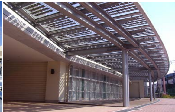
庇を兼ねた太陽光パネルを設置
