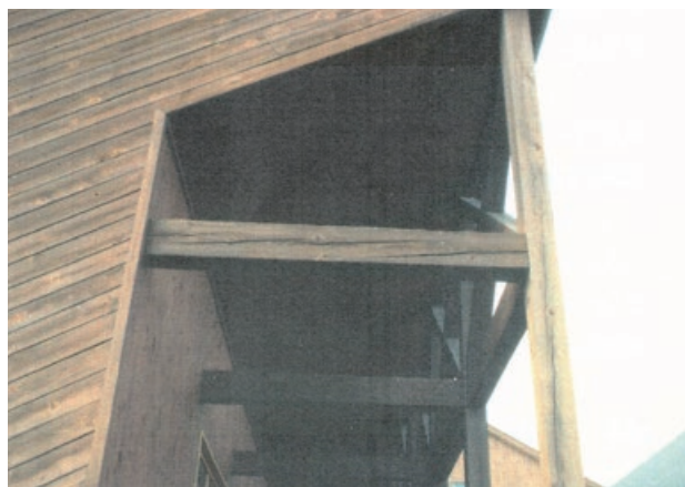
図7-2 屋外木部の割れ 1)
