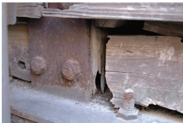
図 7-11 柱脚金物に発生した赤錆の例
