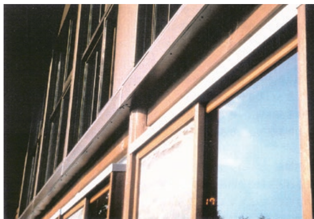
図7-13 元は木製建具であったが吹き降り時の漏水が止まらないためアルミサッシを被せた例
