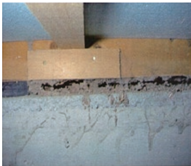
図 7-6 基礎と土台の間に詰められた蟻土
