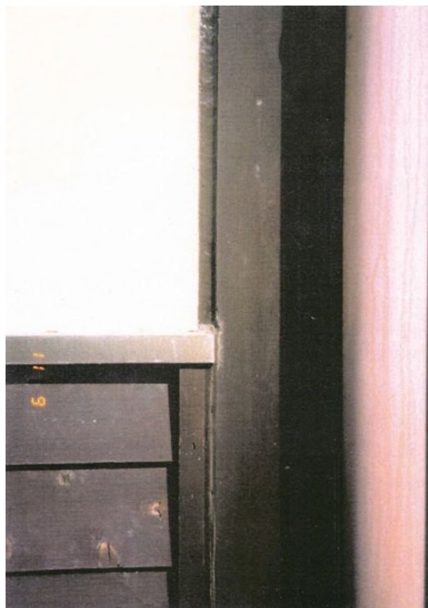
図 7-12 外壁木部とコンクリート部との界面にできた隙間にコーキングを充填している例
