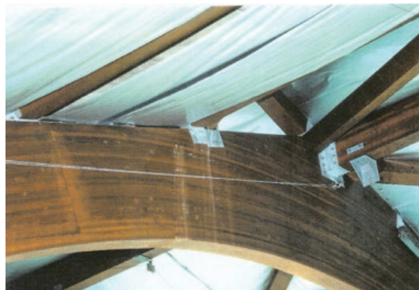
図 7-10 プール小屋組の接合金物に発生した白錆 5)
