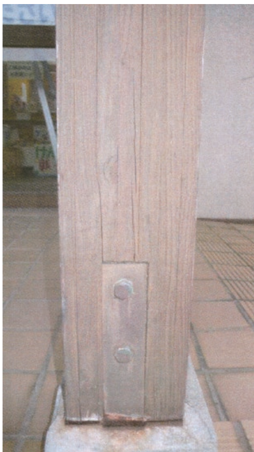
図 7-8 集成材柱脚部に生じた干割れと剥離
