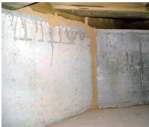
図 7-5 ベタ基礎立ち上がり部に構築されたシロアリの蟻道
