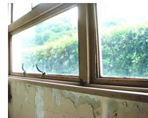
内壁クラック
