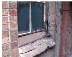
今にも落下しそうな外壁
