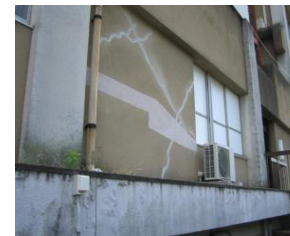
外壁クラック
