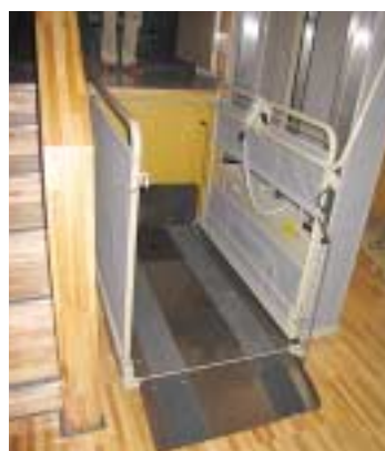
体育館に設置されたリフト段差解消器具
