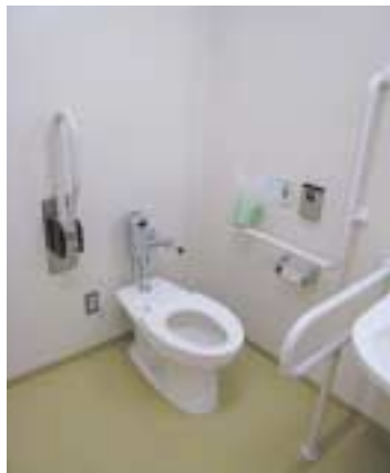
○車いす使用者用トイレ
