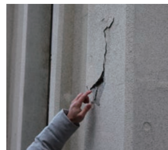
写真1. モルタルの剥落
