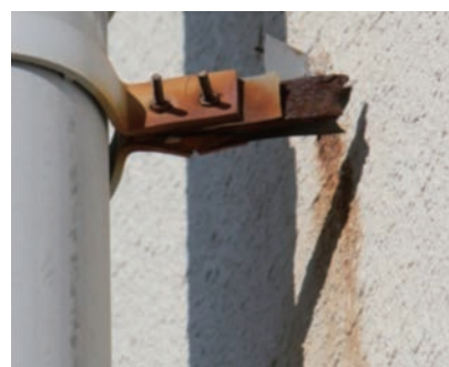
写真 1. 取付け部の腐食
