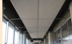
写真3. 廊下での天井の脱落
