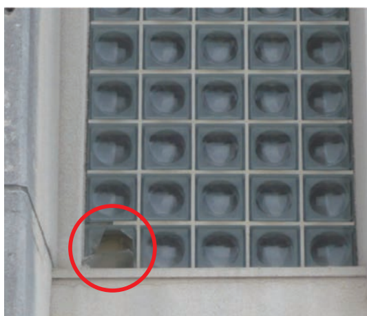
写真 1. ガラスブロックの欠損
