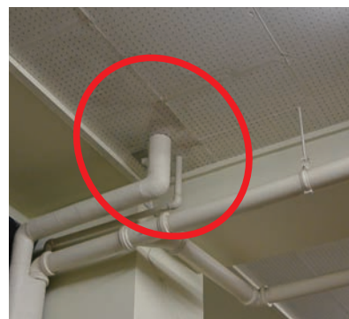
写真 1. 天井材の漏水跡
