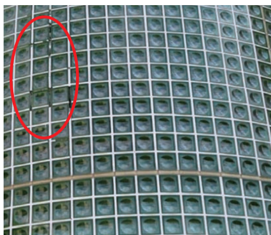
写真 2. ガラスブロックの目地部の損傷
