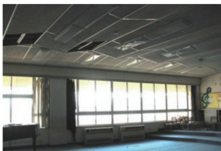
写真2. 音楽室の折れ曲がり天井の被害
