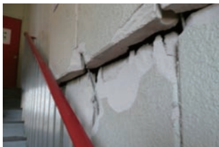
写真2. 地震によるALCパネルの被害例
