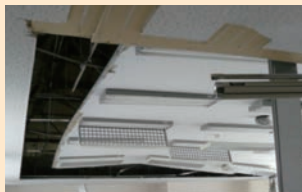
写真8. 天井裏の設備の脱落
