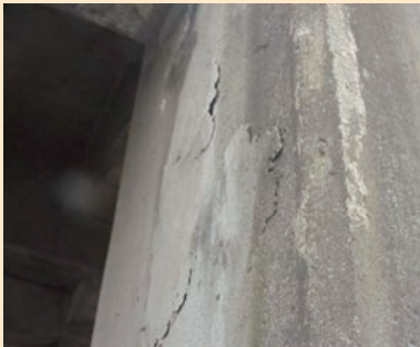
写真 3. かぶりコンクリートの浮き 13)
