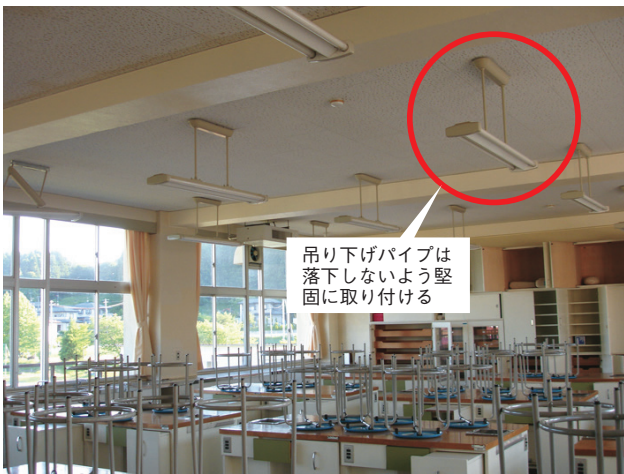
写真1. 吊り下げ形照明器具 (教室)
