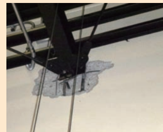
写真2. コンクリート壁との接合部の破壊
