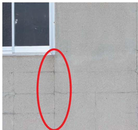
写真2. コンクリートブロックの目地部のひび割れ
