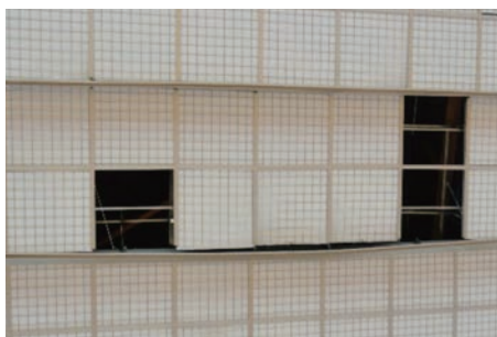
写真2. 天井材の一部脱落（下からの見上げ）
