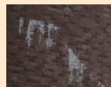
写真1. エフロレッセンス
