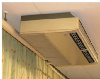
写真2. 天吊りエアコン
