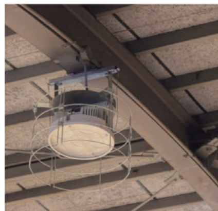
写真 1. 屋内運動場の照明器具
