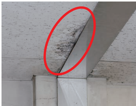
写真1. 天井の漏水跡
