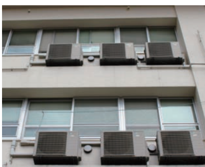
写真 1. 上階に設置された空調室外機
