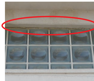
写真2. 古い工法によるガラスブロック壁 （モルタル部分にひび割れ）
