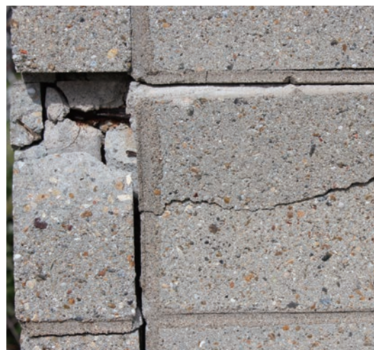
写真3. コンクリートブロックの欠損、ひび割れ
