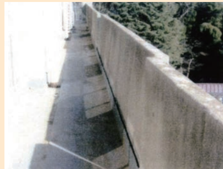
写真 1. バルコニー先端のRC造腰壁の傾斜
