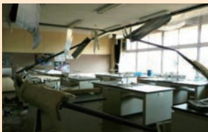
写真7. 天井裏の設備の脱落
