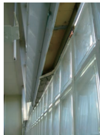
写真 1. 地震によりブロック構面中央部がせり出した例
