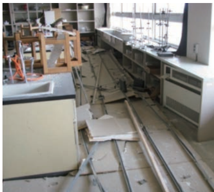
写真 2. 脱落した天井材
