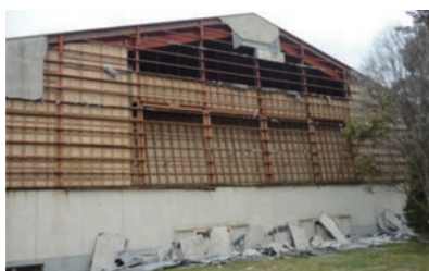
写真1. 地震によるラスモルタルの被害例
