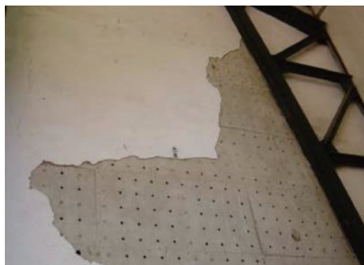
写真2. モルタルの剥落（内壁）
