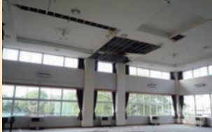
写真1. 階高の高い大空間での天井の脱落
