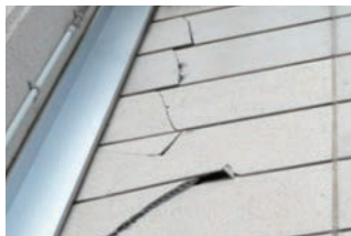
写真3. 地震による押出成形セメント板の被害例
