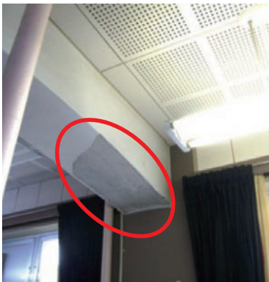
写真1. 教室梁下のモルタルの剥落
