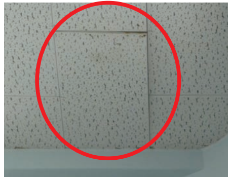
写真2. 天井材のずれ
