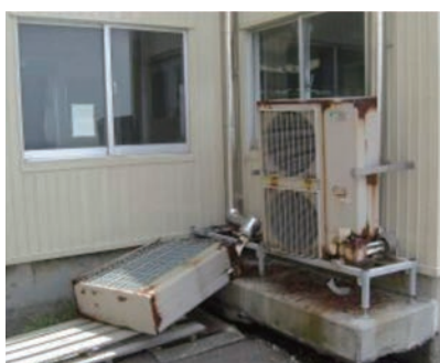
写真 2. 空調室外機の転倒
