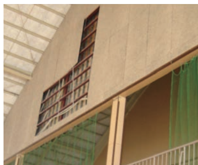
写真2. 内壁ボードの脱落
