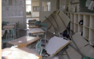
写真2. 普通教室での天井の脱落
