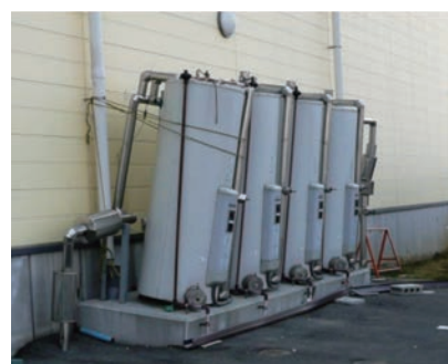
写真 3. 給湯設備の傾斜
