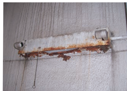
写真 1. 照明器具の腐食 3)
