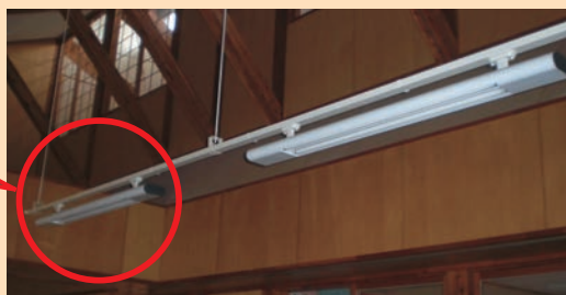
写真 1. レースウェイ取付け照明器具
