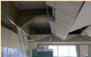
写真4. 音楽室の折れ曲がり天井の脱落
