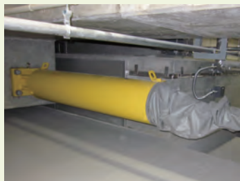
免震装置を「見える化」した例。 見学者に分かりやすいよう照明を付け、用途ごとに装置の色分けをしている。(和歌山県立和歌山工業高等学校)
