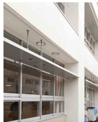
② 南側の窓には、直射日光を遮り、反射させた光を天井面に拡散させるライトシェルフ(ひさし)が取り付けられている。
