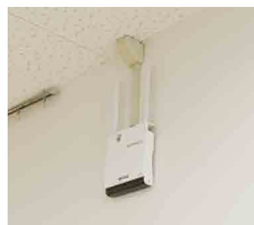
⑫ 校内ネットワークは無線LANにより構築されている。無線LANアクセスポイントは廊下の壁に取り付けてある。
