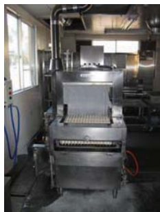
食器洗浄機(更新前)の写真
