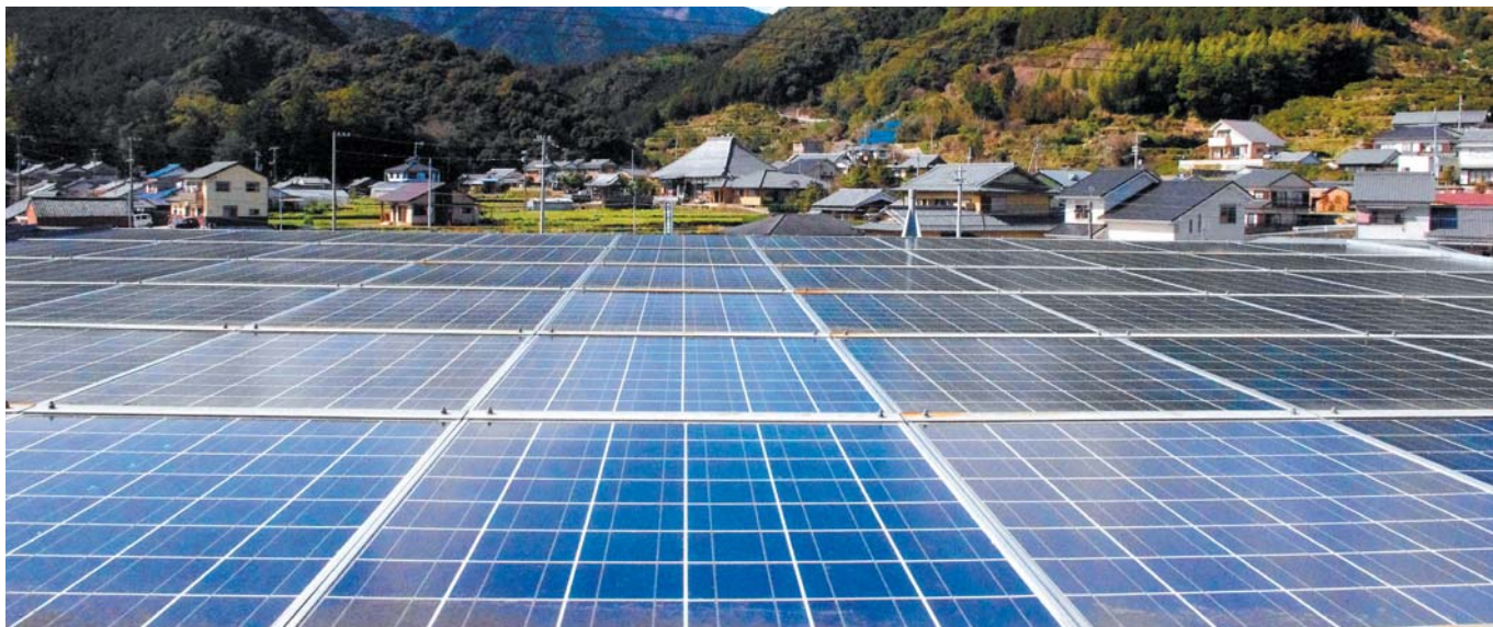
9 屋上に設置された太陽光パネル
