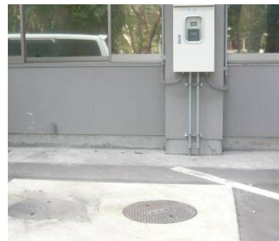
地中に設置されたモニター槽と外壁に設置されたPH監視装置
