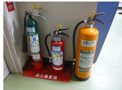
使用する物質に合った消火ができるよう3種類の消火器等を設置している
