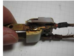
トラッキング火災により燃焼したコンセントとコンセントプラグ
