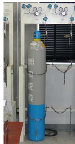
2点で固定されたボンベ
