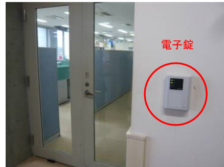
電子錠を設けた扉
