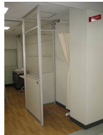
目隠しを設けた緊急シャワー
