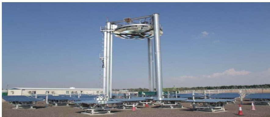
タワー型太陽熱発電技術実証実験プラント（アブダビ、UAE）
