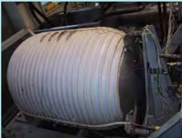
加温・冷却パイプ
