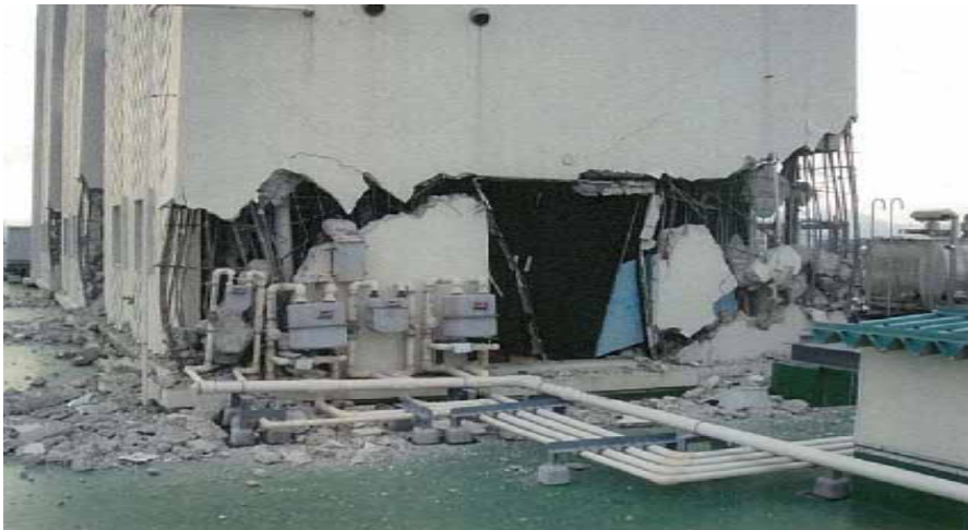
○東北大学 大学院工学研究科 被害： 建物屋上部は柱・壁ともに崩落
