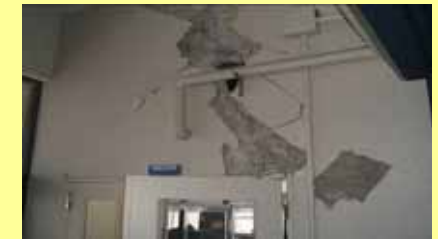
地震により亀裂が入り、剥がれ落ちた壁
