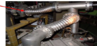
7階 絶縁ガス流出による真空ライン破損
