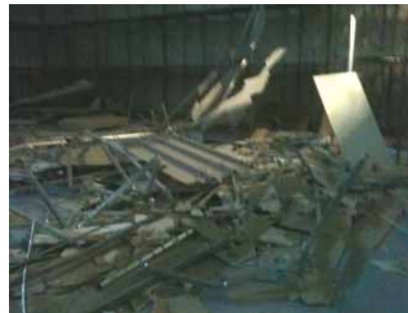
宇宙ステーション試験棟の被害
