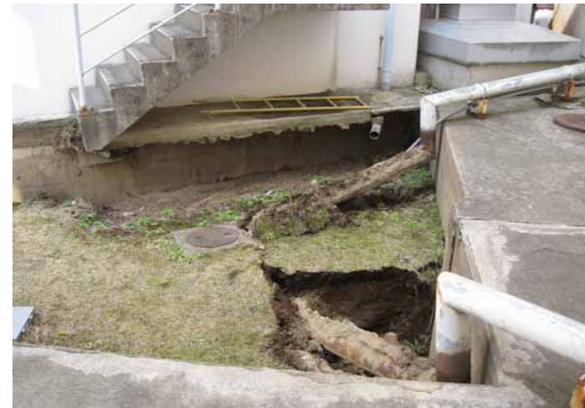
建家周辺の地盤沈下
