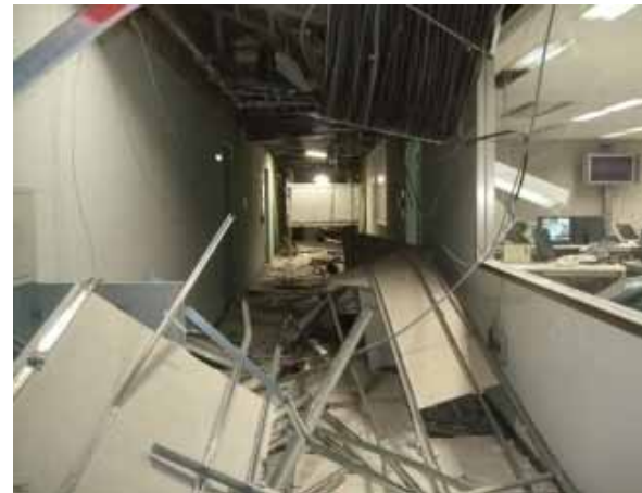
宇宙ステーション運用棟の被害
