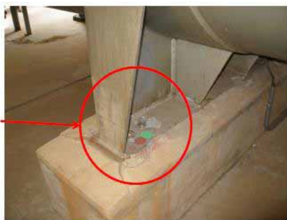
ロケットエンジン燃焼試験設備の基礎の損壊
