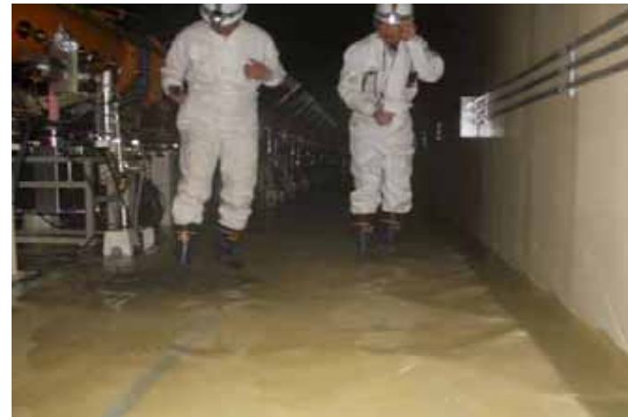
地下水により10cmまで浸水
