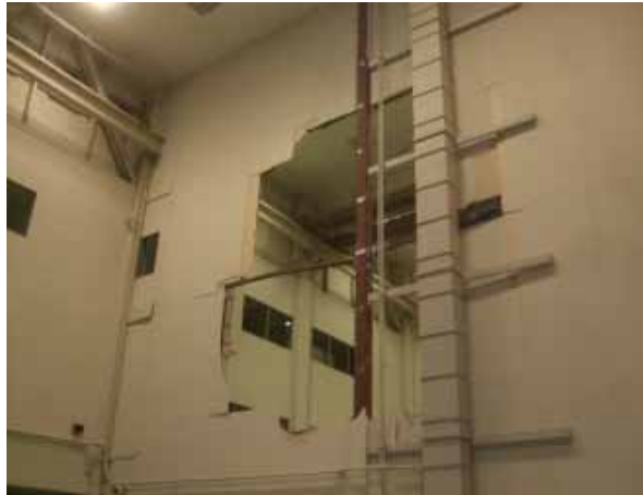
総合環境試験棟(衛星の試験等を行う施設)の被害
