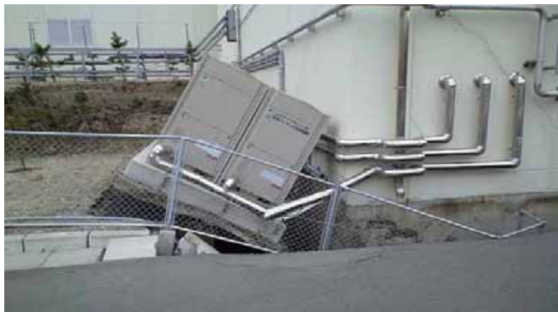
周辺の陥没と室外機の傾斜
