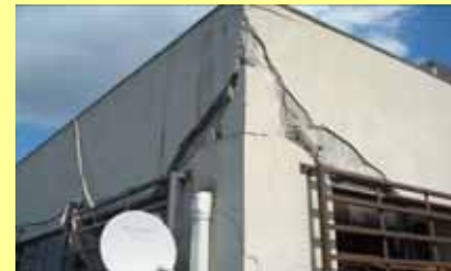
外壁が剥がれ落ちた校舎
