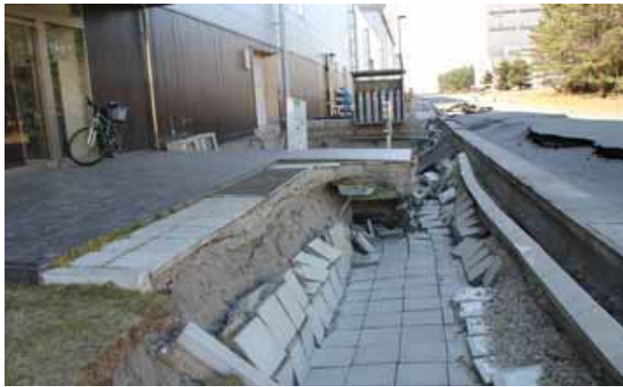
広い範囲で約1.5メートルの陥没
