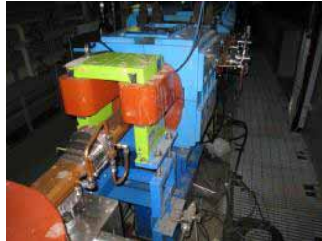
PF-AR:トンネル接続部から泥水の噴出
