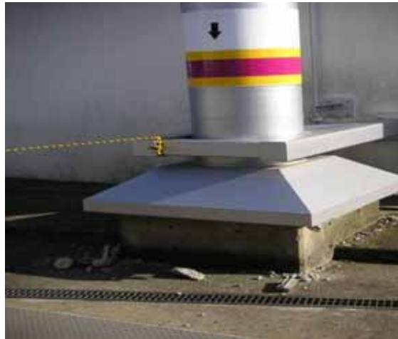
排気ダクト接続部破損の可能性
