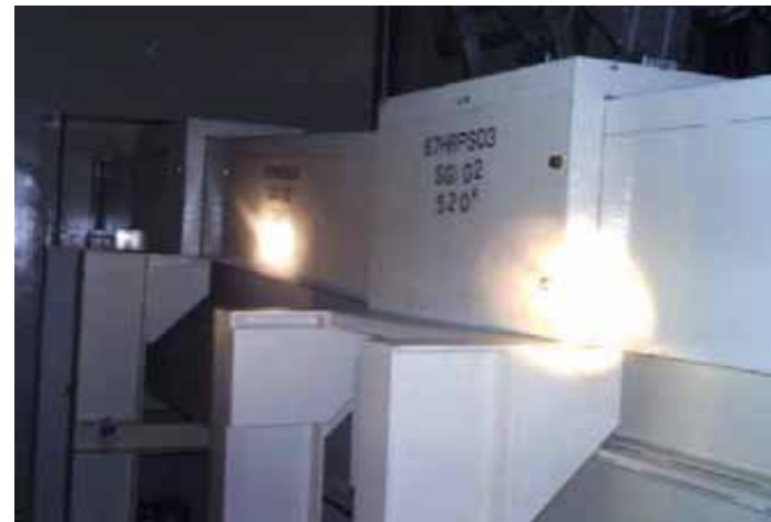
遮へい内のガイド管のミラーが全数破損
