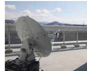
通信接続に必要な可搬型アンテナ(径 1m)。
