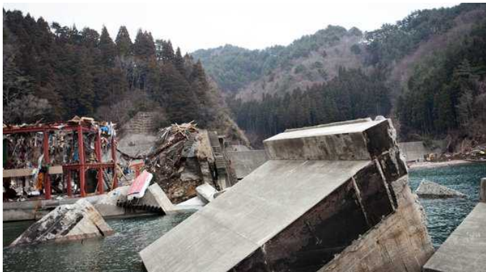
津波で崩壊した防潮堤
