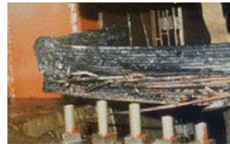
1989年に大停電を引き起こした磁気嵐で被害を受けたニュージャージー州の原発の変圧器
