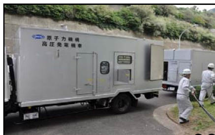
移動電源車による設備への電源供給
