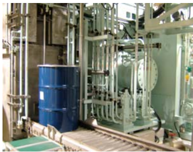
高圧圧縮装置ドラム缶搬入部 付近外観
