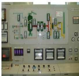
焼却処理設備のコントロールパネル
