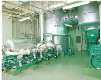
焼却処理設備
