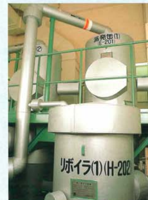
蒸発処理装置
