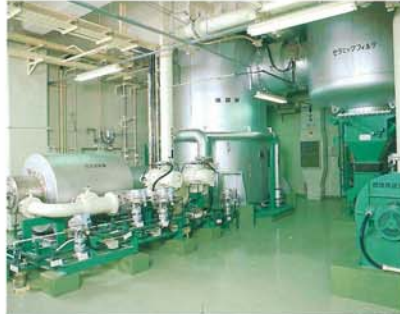
焼却処理設備
