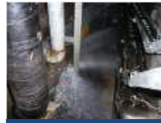
配管の破損による水漏れ
