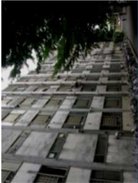
外壁・サッシの落下の危険
