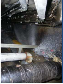
配管の破損による水漏れ
