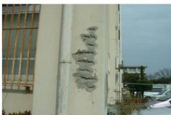
柱コンクリートの剥落 鉄筋の露出
