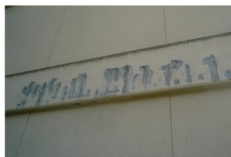
梁コンクリートの剥落 鉄筋の露出
