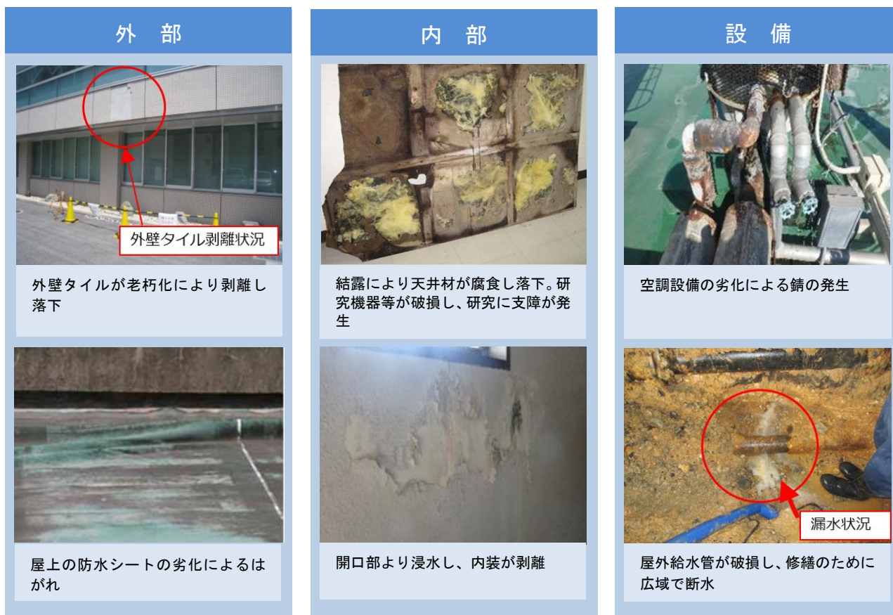
図4 施設・設備の老朽化の状況
