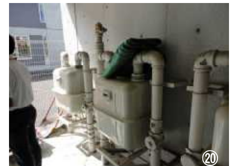
▲普段は都市ガスを使用しているが、非常時にはプロパンガスを使用できるように、ガス変換機の接続口を配備。
