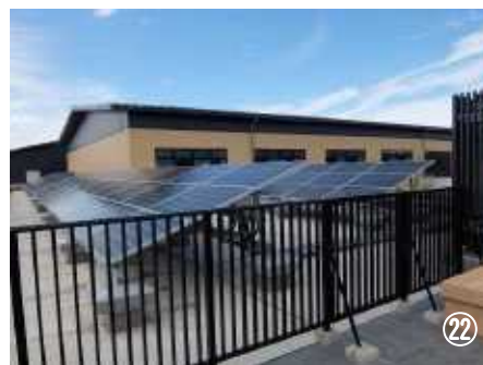
▲太陽光パネル。
