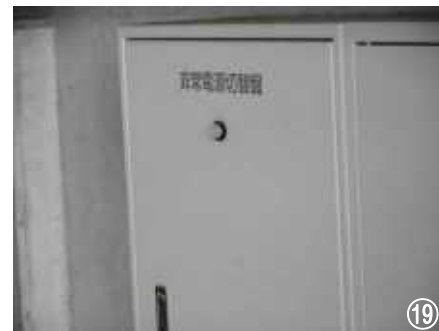
▲非常電源切替盤。
