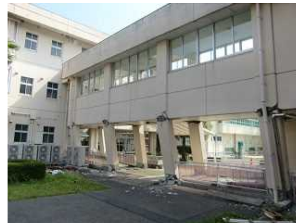
渡り廊下の倒壊（益城町立木山中）
