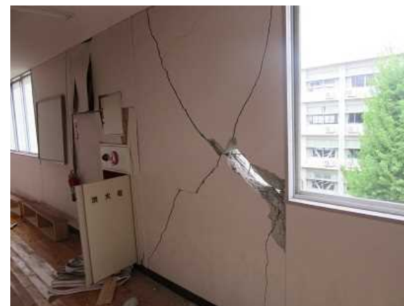
3 F 校舎廊下の壁破損（熊本高校）
