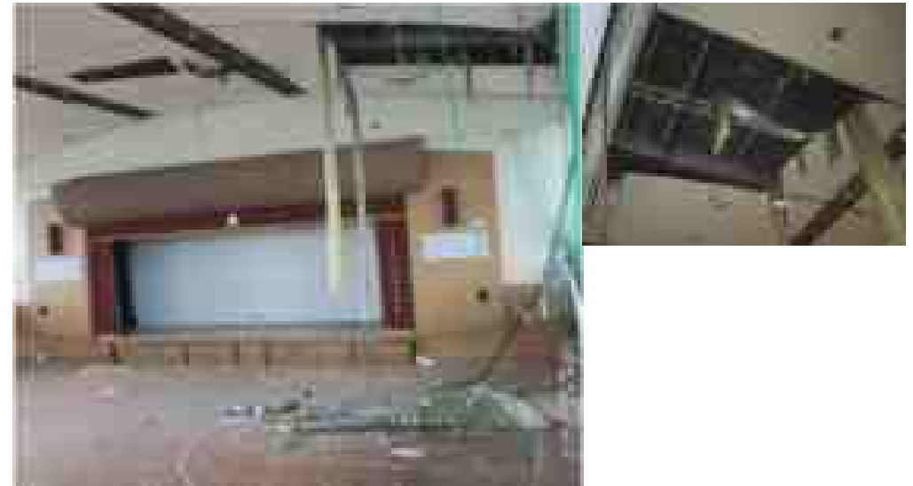
吊り天井が落下した体育館
