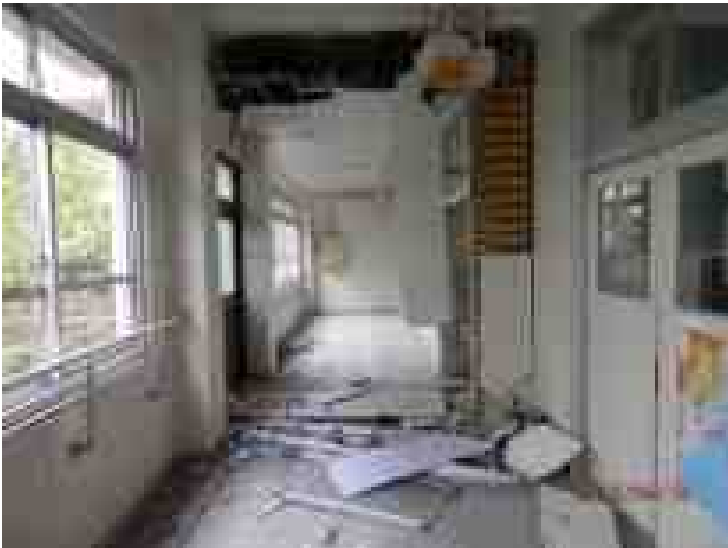
廊下の天井材が落下
