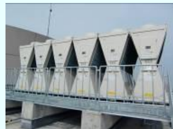
更新された空調屋外機
