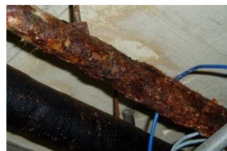
◇給水管の漏水◇(被害額1億円以上) 屋内給水管(経年39年) —東北大学—
