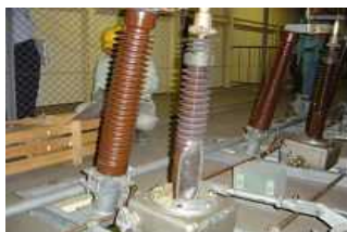
◇全学停電◇ 特高受変電設備(経年27年) —筑波大学—
