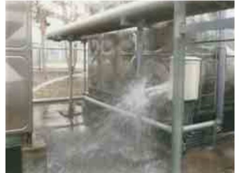
高エネルギー加速器研究機構 （受水槽の破損）
