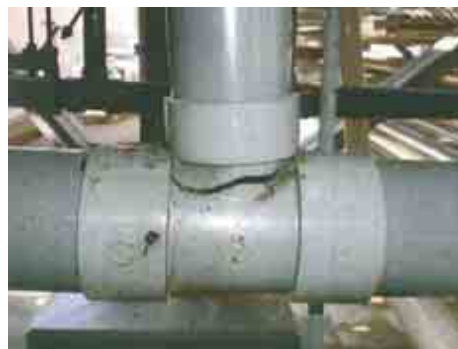
筑波大学（排水管の破損）
