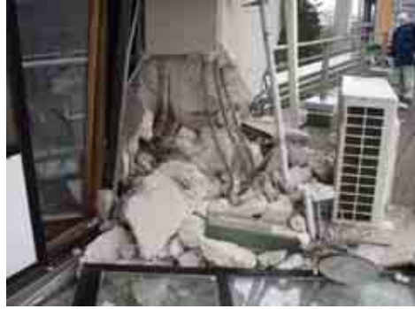
東北大学（柱の崩壊）
