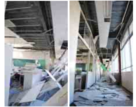
茨城大学（内装材の崩落）
