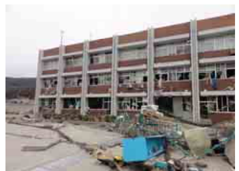
東京大学（津波による建物等の損壊）
