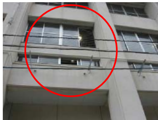
障子の落下箇所
