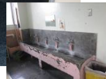
トイレの老朽化による臭気
