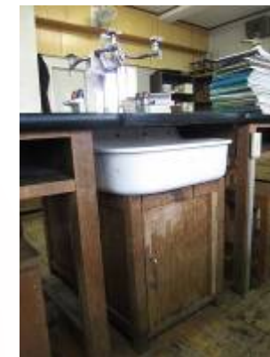
度重なる配管の破損
