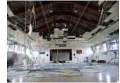
非構造部材の落下
