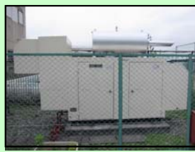
自家発電設備
