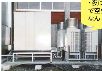
省エネルギー・省資源型 (深夜電力利用冷暖房装置)
