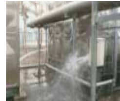
高エネルギー加速器研究機構 (受水槽の破損)
