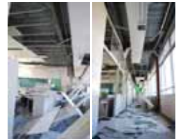
茨城大学(天井材の落下等)
