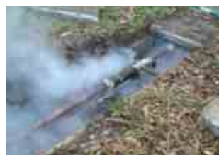
屋外蒸気管の漏れ
