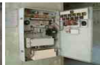
老朽化した自動火災報知器
