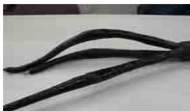
経年劣化により漏電したケーブル
