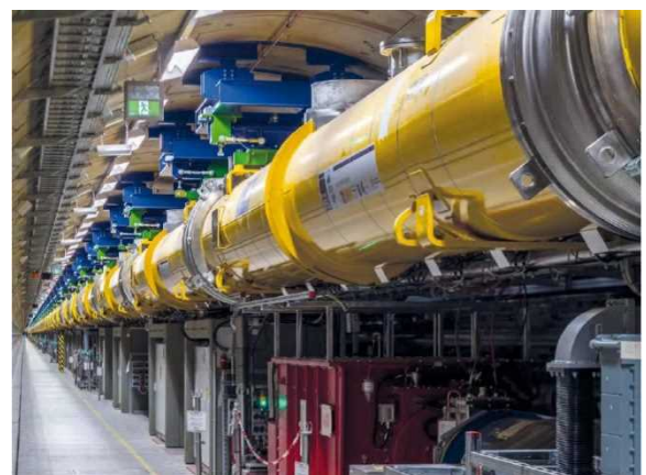
直線加速器のモジュール
