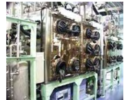
金属燃料製造試験設備 (大洗燃研棟)
