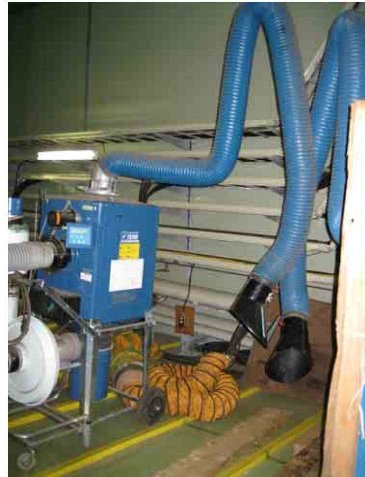
局所排気設備
